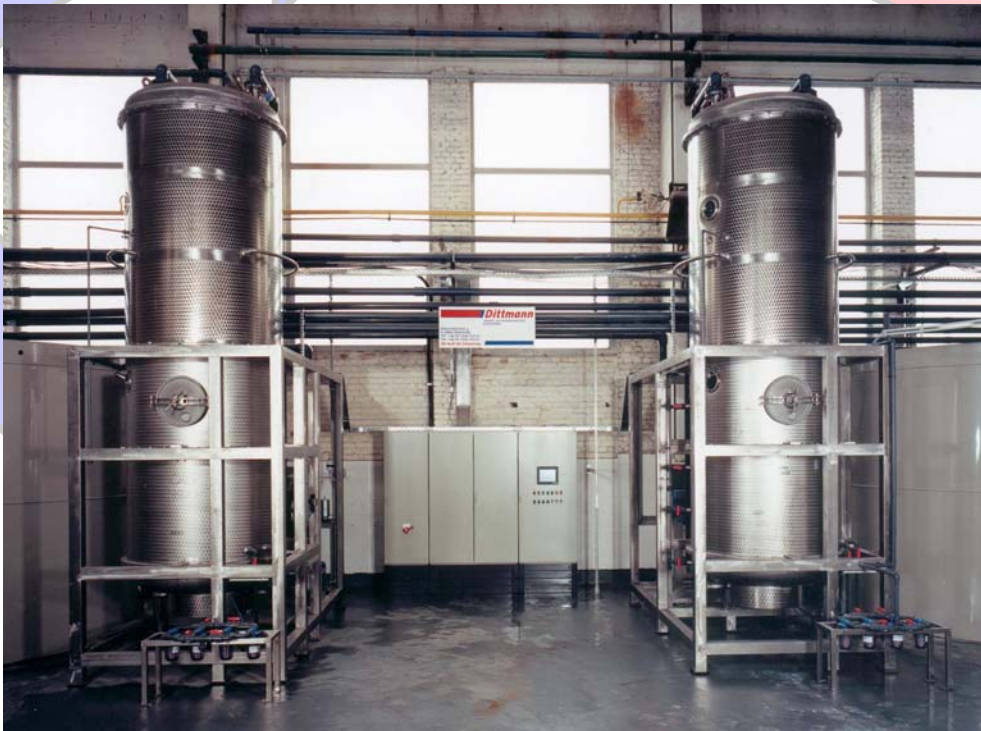
2 Stück fremdbeheizte Vakuumverdampfer
